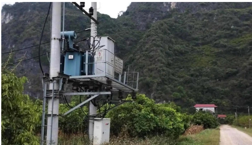
Trạm biến áp thôn tự nhiên tại ca
